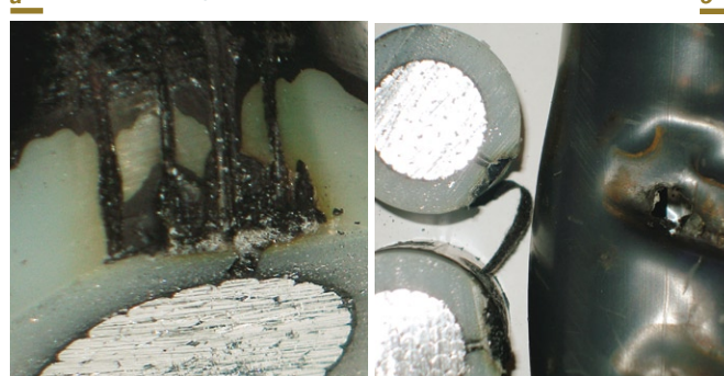
Рис. 4. Радиальный пробой «жила-экран» (а) и прогорание внешней оболочки (б) кабеля СПЭ 35 кВ присоединения с дуговой сталеплавильной печью металлургического завода
