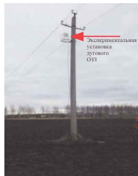
Рис. 6. Экспериментальная установка дугового ОЗЗ при натурном эксперименте воспроизведения ОЗЗ на фазе С в сети напряжением
