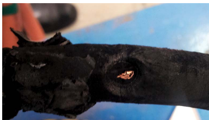
Рис. 5. Пробой изоляции кабеля
