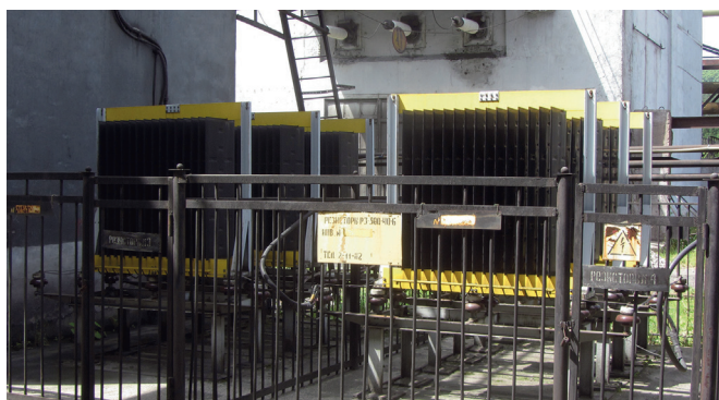
• Рис. 6. Два резистора сопротивлением 300 Ом в нейтрали ГРУ 6 кВ ТЭЦ НКМК
