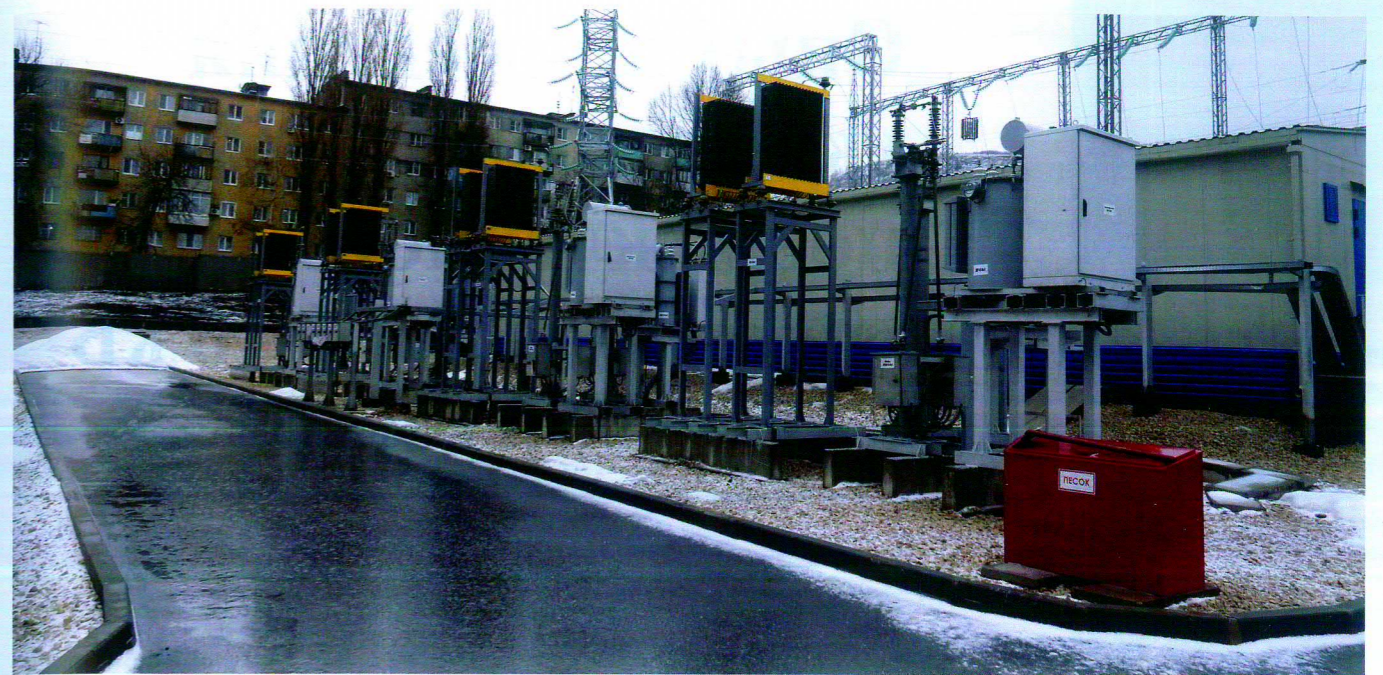
Рис. 4. Высокоомная резисторная установка на ПС 110/6 кВ «Западная» Центрального ПО филиала ПАО «МРСК Волги» — «Саратовские распределительные сети», установленная параллельно статическому ДГР с конденсаторным управлением
