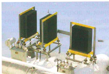
Рис. 4. Резисторы на основе композиционного материала в сети СН Камчатской ТЭЦ-2
