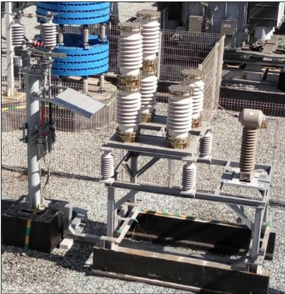
Сеть 35 кВ нефтеперерабатывающего завода, Пермь
