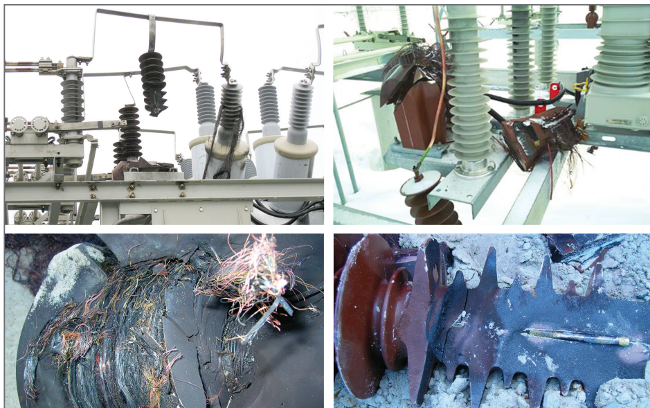
Рис. 2. Характерные повреждения литых ТН в сети 35 кВ
