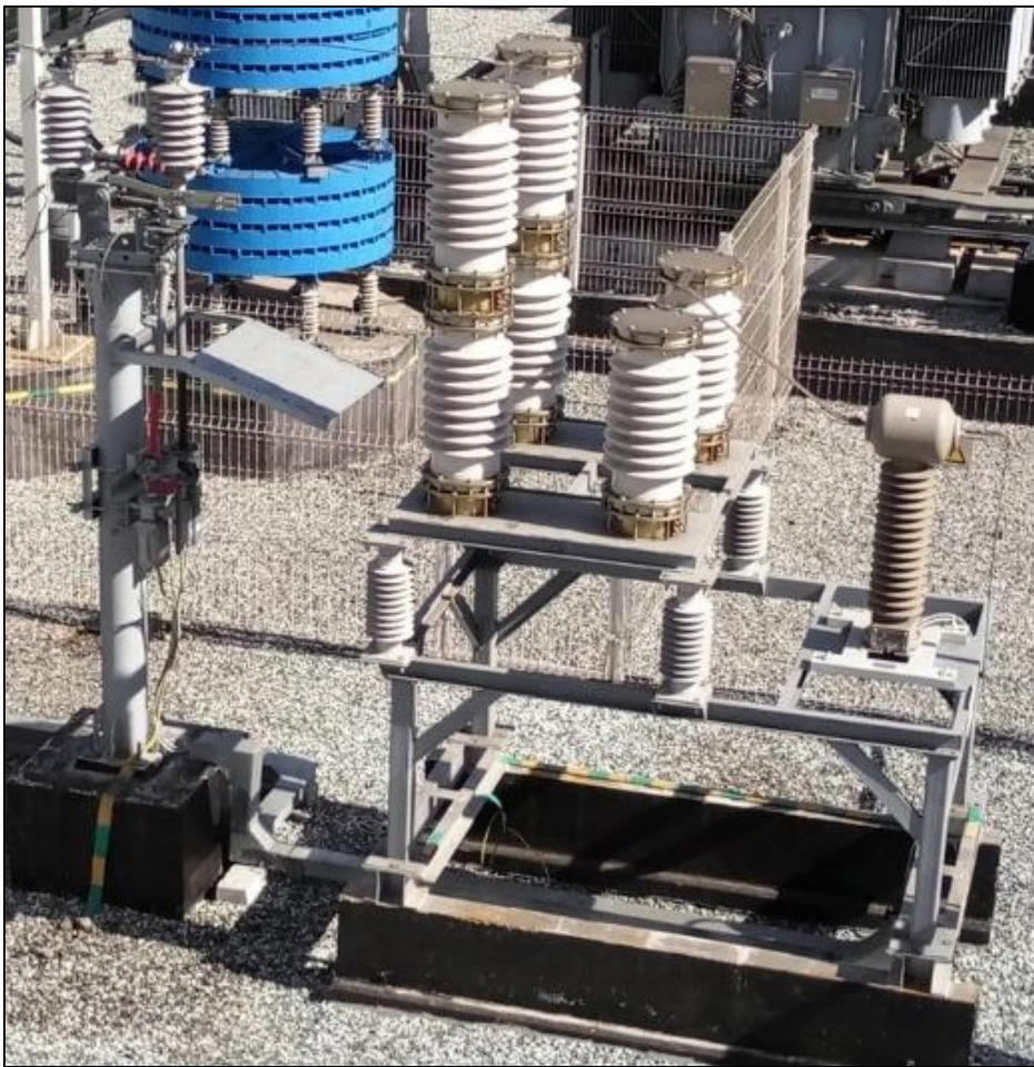
Сеть 35 кВ нефтеперерабатывающего завода, Пермь
