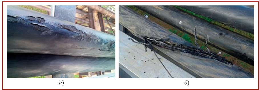
Рис. 1. Перегрев (а) и перегор (б) экранных проволок аварийными токами в экране одножильного силового кабеля
