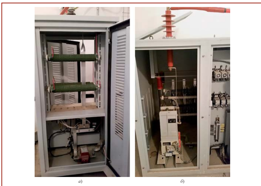
Рис. 5. Шкафы демпфирующего резистора RNK-6 (а) параллельного резистора BLX-6 (б)
