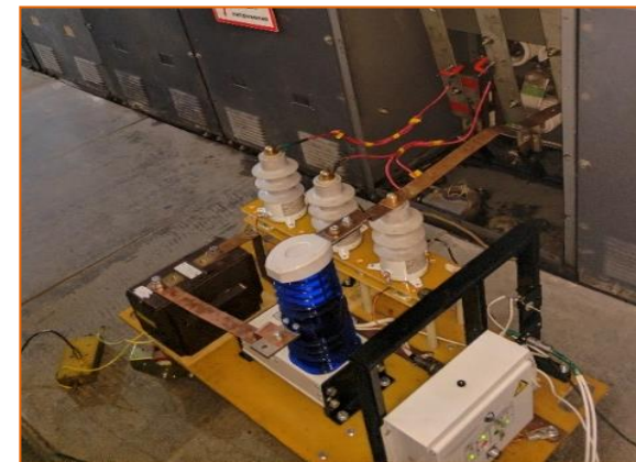
Натурное обследование электрических сетей
