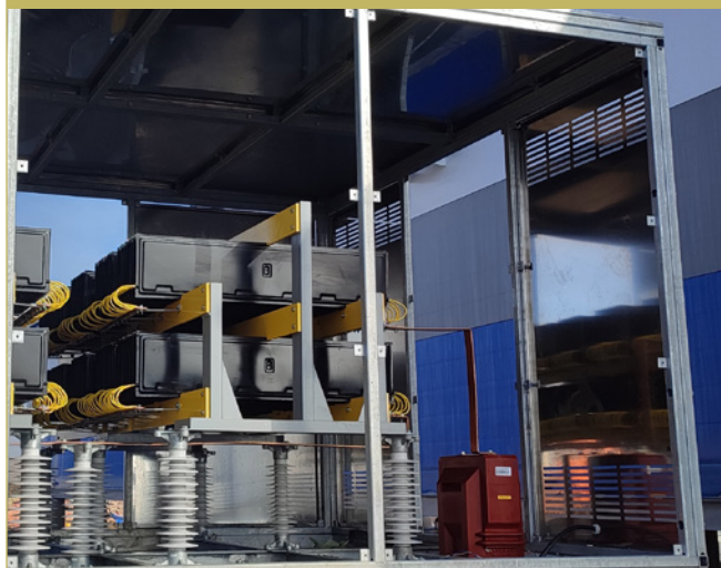
Комплектное устройство для заземления нейтрали 75 Ом/35 кВ/10 с
