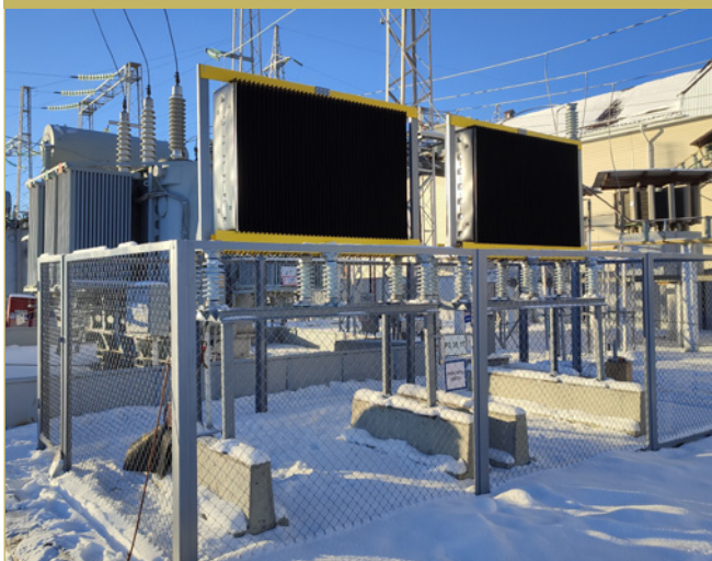
Высокоомный резистор 6900 Ом/35 кВ
