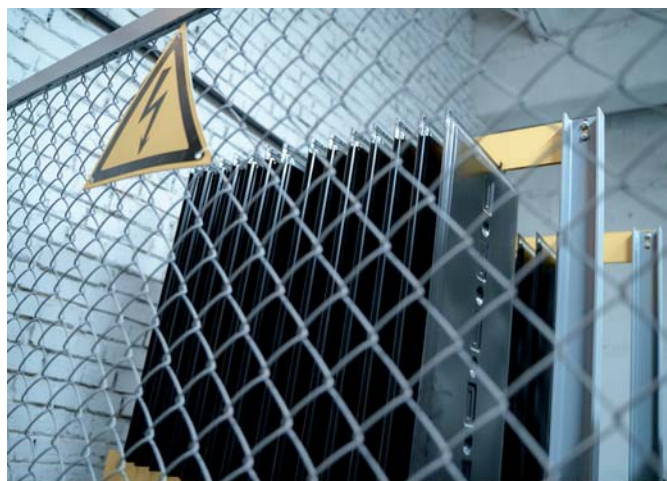
Резисторы «Болид» на ПС Воинская, г. Новосибирск
