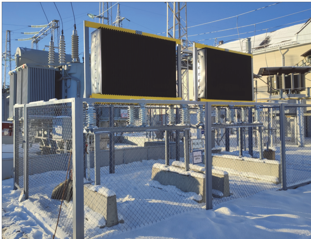
Рис. 6. Высокоомные резисторы 6900 Ом/35 кВ/ длительной работы на ПС 110/35/6, включенные в нейтраль силового трансформатора 40 МВА
