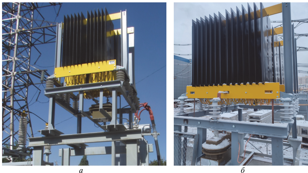
Рис. 13. Низкоомные резисторы открытой установки на ПС 110 кВ Чуйских электрических сетей, Кыргызстан ( а – 50 Ом / 115 А / 10 кВ / 10 с) и на ПС 110 кВ в ПАО «Ленэнерго» ( б – 29 Ом / 200 А / 10 кВ / 10 с)
