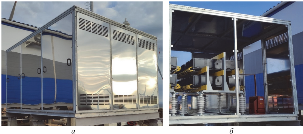
Рис. 12. Устройство низкоомного резистивного заземления с параметрами 35 кВ / 75 Ом / 270 А / 10 с на Кузьминской ВЭС в закрытом корпусе (а) и снятыми боковыми панелями для техобслуживания (б)
