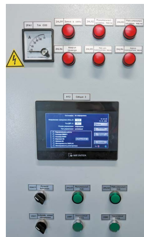
Рис. 4. Автоматика управления дугогасящего агрегата 10 кВ в обследуемой сети
