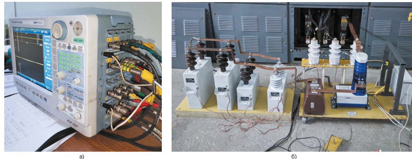
Рис. 2. Внешний вид цифрового осциллографа (а) и испытательной установки с однополюсным выключателем и комплектом асимметрирующих конденсаторов на фазе (б)
